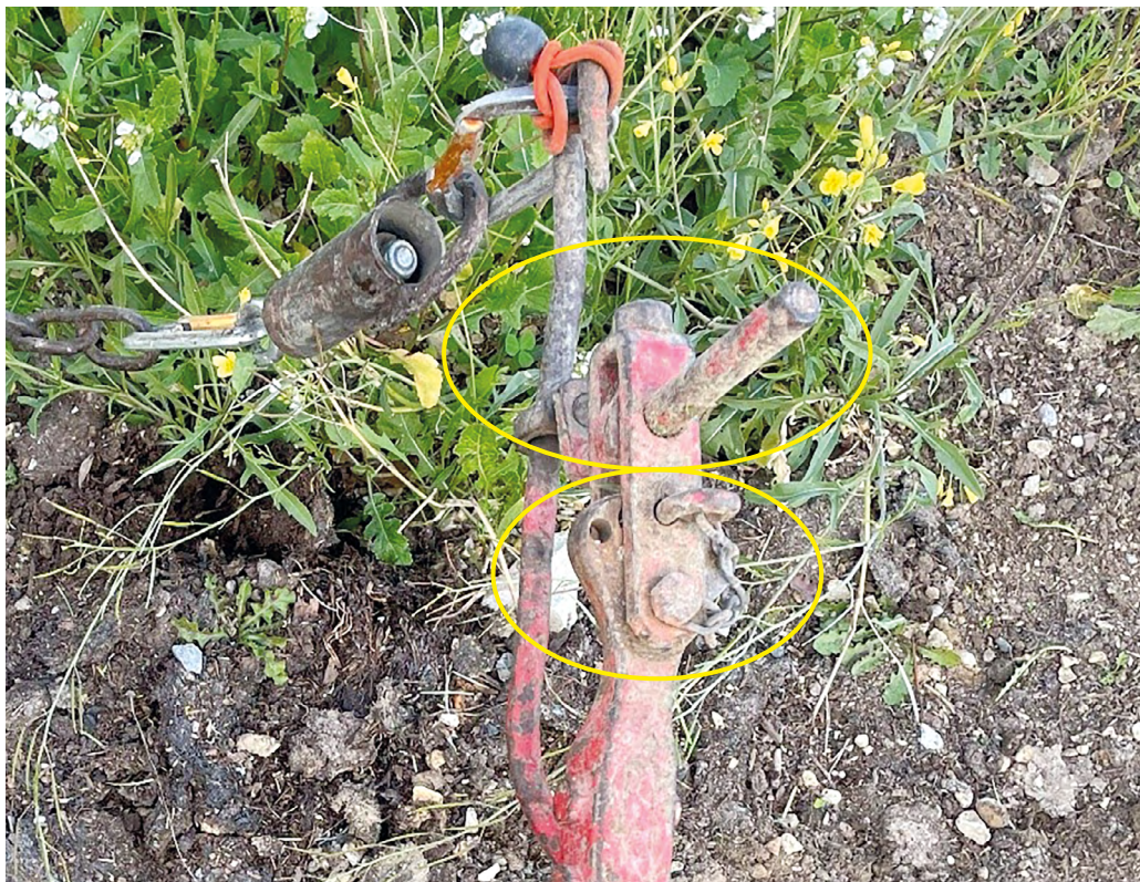
Figure 1-13 : Vue du dessus des régulateurs vertical (cercle du haut) et horizontal (cercle du bas)
